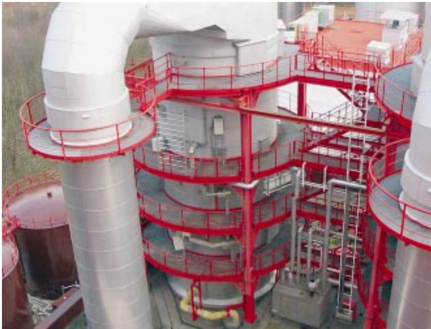
Teil der Rauchgasreinigung in der Müllverbrennungsanlage Bielefeld.
