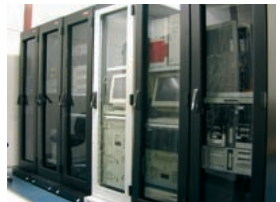
Serverraum nach dem Umbau
