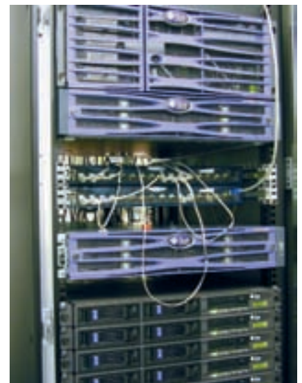
Neue Server- und Speicherkapazitäten des HNI
