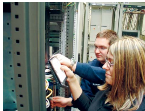
Auszubildende des IMT bei Arbeiten am Serverschrank (Foto: PUZ 1/2008)
