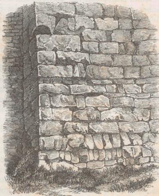
Das Mauerwerk am Thurme C.
