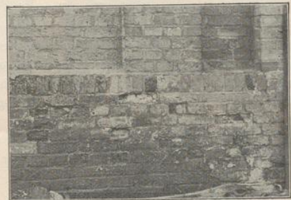
Abb. 2. Auswittern einer Backsteinwand, deren weniger gut gebrannte Steine theilweise schon abgeblättert sind.
