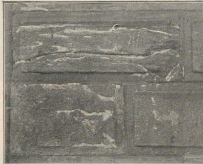
Abb. 1. Auswittern von Sandsteinquadern, deren Adern bereits ausgebröckelt sind.
