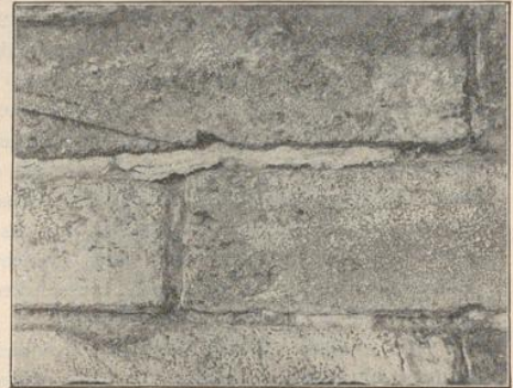
Abb. 3. Ausblühen der Mörtelfugen.
