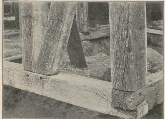
Abb. 3. Auswittern von Hölzern, deren Oberflächen rau und mit tiefen Furchen bedeckt werden.
