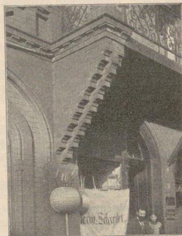
Abb. 3. Moderne Console in Backstein unter Balconplatte.
