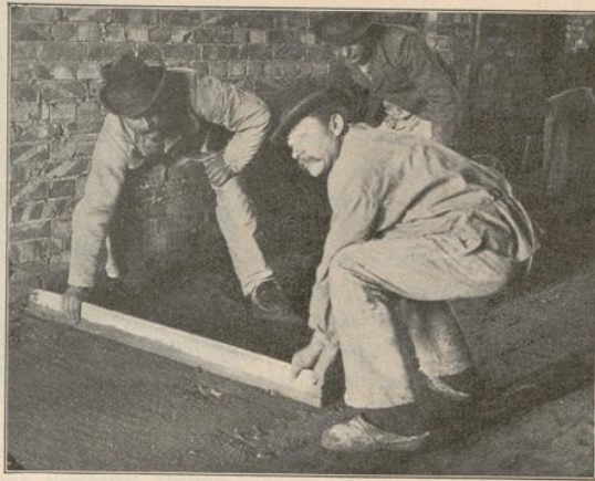
Abb. 3. Cementestrich. Der auf die Unterlage ausgeschüttete und mit der Kelle zwischen Lehrlatten geebnete Cementmörtel wird mit dem Richtscheite abgezogen.
