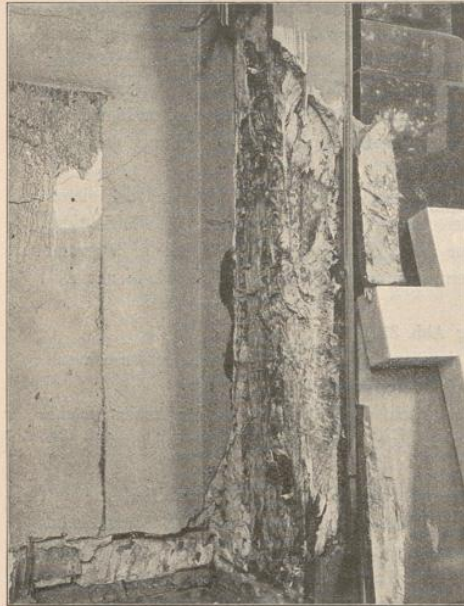
Abb. 1. Hausschwamm. Mycelium unter einer Thürbekleidung verdeckt an einem Pfosten eines leichten Fachwerkbauwerks gewachsen. Die Zerstörung des Pfostens ist unten schon ersichtlich.
