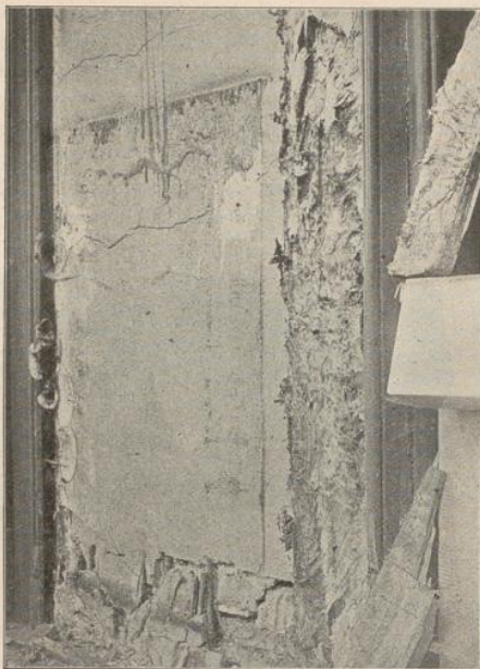
Abb. 5. Hausschwamm. Links tritt das Schwammgewächs unter der Verkleidung an's Licht hervor, Fladen bildend und mit solchen auf den Putz übergreifend.
