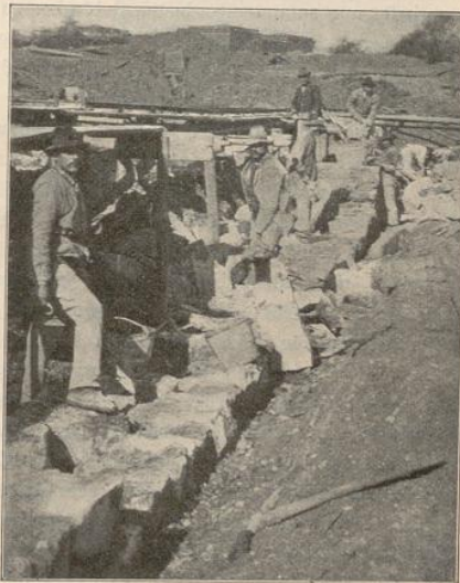
Abb. 55. Mauern in Bruchstein. Die Enden werden zuerst mit Abtreppung hochgemauert; dazwischen wird gerade das Mauerwerk ausgefüllt, Kalkkästen und Wassereimer zum Anlassen stehen auf der Mauer.
