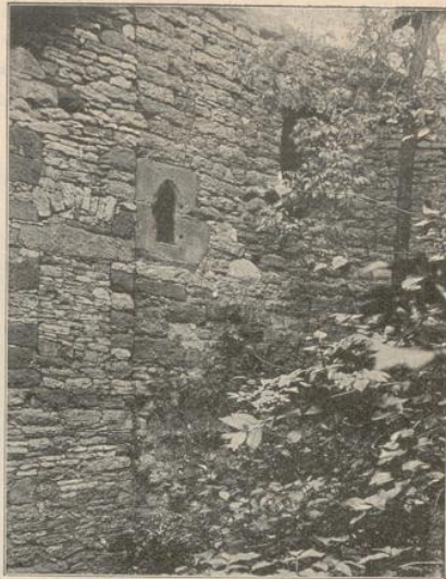
Abb. 3. Mauern. Bruchsteinverband, bei dem rechts eine Schichtung durch abgleichende Verzwickung angestrebt ist, während links nur das Bestreben, die vielfach recht kleinen Steine lagerhaft zu vermauern, bestanden hat.
