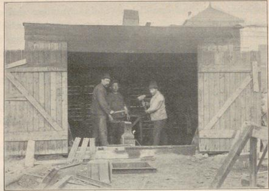
Abb. 1. Schuppen für eine Feldschmiede; er besteht nur aus einigen Bauhölzern mit Bretterbekleidung.
