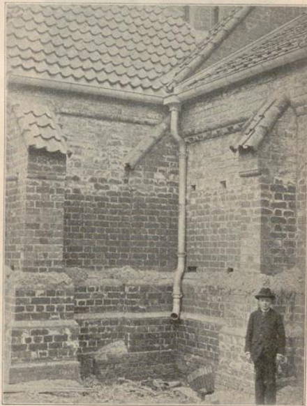
Salz. Die in den Backsteinen enthaltenen Salze blühen aus, nachdem die Steine vermauert sind. Das zeigt sich bei den einzelnen Steinen als weißer unregelmäßiger Rand. Beseitigung durch Abwaschen mit verdünnter Salzsäure und durch gründliches Nachspülen mit reinem Wasser.
