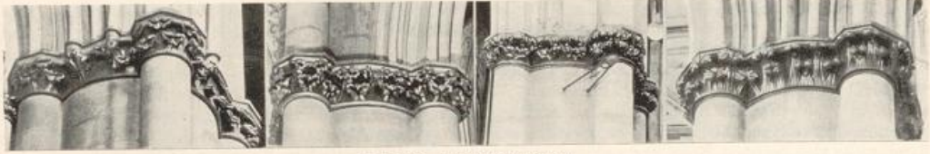
Abb. 125. Liebfrauenkirche. Vierungspfeiler. Kapitelle. 1. SO.-Pfeiler. 2. NO.-Pfeiler. 3. SO.-Pfeiler. 4. NW.-Pfeiler.
