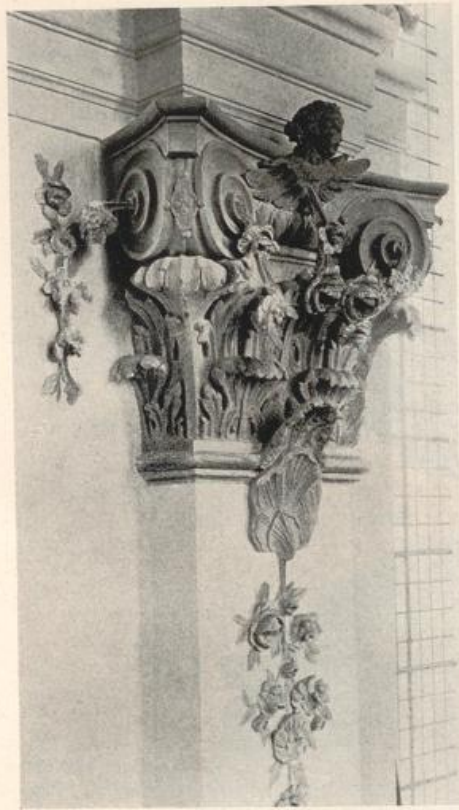
Abb. 244. Paulinuskirche. Pilasterkapitell nach der Instandsetzung.
