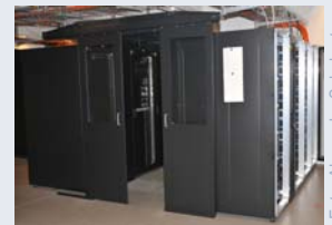
Klimaschrank im Datacenter
