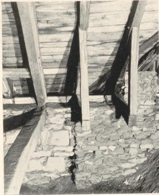
Abb. 105. Liebfrauenkirche. Baufuge über dem Chorgewölbe.
