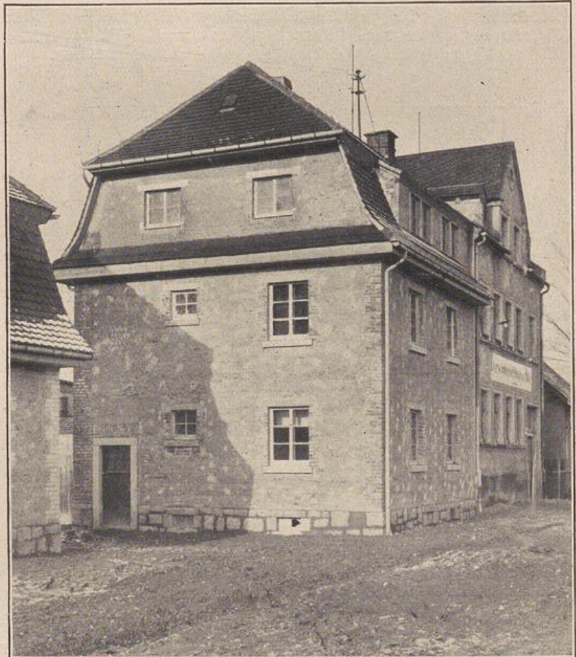
Abb. 9: Dreigeschossiger Lehmstampfbau, ausgeführt vom Bezirksbaumeister Dunkel (Rehau), der unversehrt über den Winter gestanden hat.
