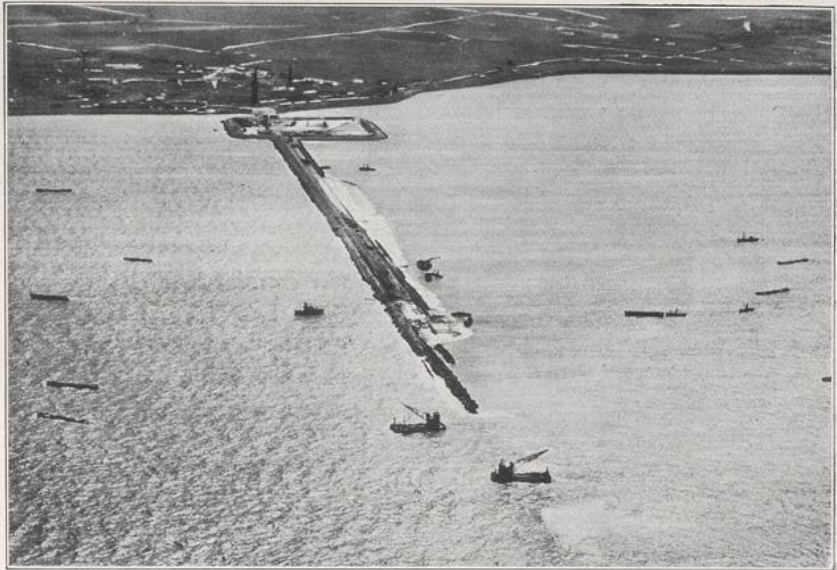
420. Einpolderung der Zuidersee. Fliegeraufnahme vom 4. Mai 1928 des im Bau begriffenen, inzwischen vollendeten Deiches, der den Nordwest-Polder der Zuidersee von Medemblick bis zur Ostecke der Insel Wieringen begrenzt. Die Eindeichung des Wieringermeer-Polders ist beendet, seine Trockenlegung hat begonnen. (Aufnahme der K. L. M., Königl. Holl. Luftreederei — H. L.)
