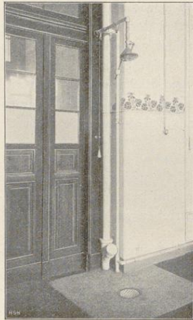
Fig. 118. Türbrause in den Arbeitsräumen.
