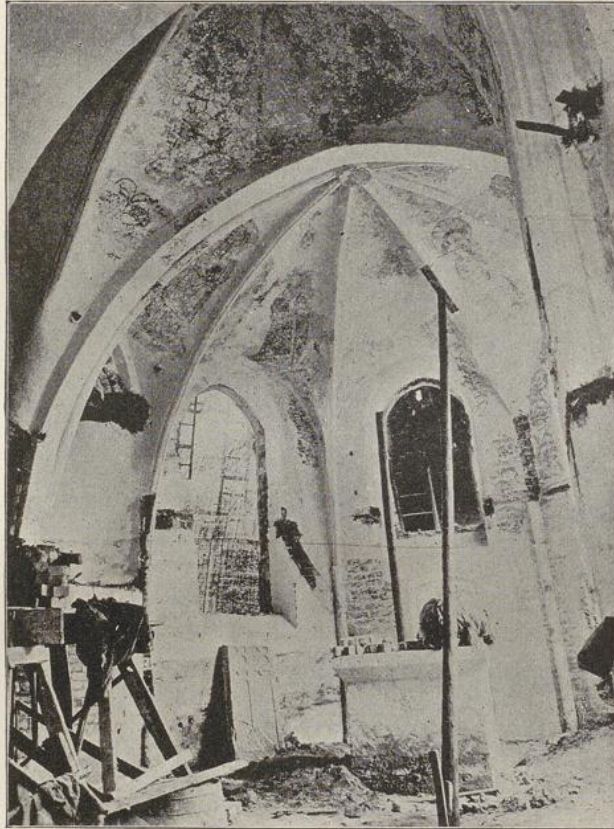
Fig. 16. Kirche in Kirchhorst; Chor vor der Wiederherstellung.
