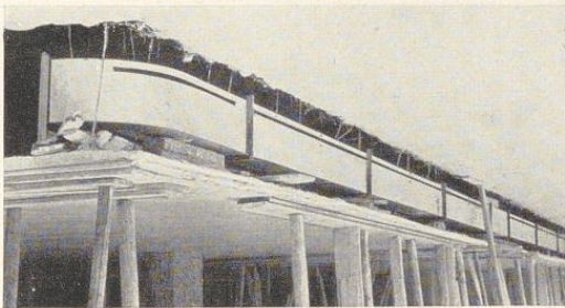
Bild 765. In Rabitzdecke eingebauter Entlüftungskanal. Universum-Filmtheater, Stuttgart
