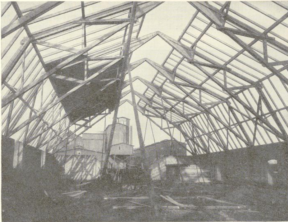
Abb. 106. Große Lagerhalle für ein chemisches Werk. Entworfen und ausgeführt: Zimmermeister B. d. Z. Karl Peters, Nienburg.
