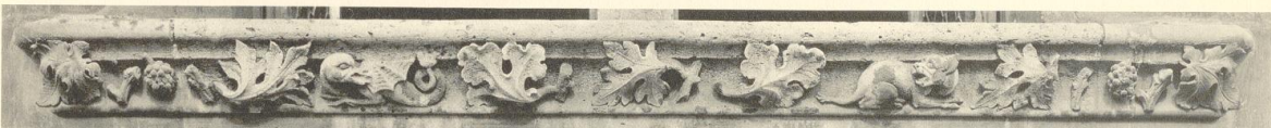
COMPIÈGNE. HOTEL DE VILLE. Étage supérieur et lucarnes de la façade principale Cordon sculpté sous les fenêtres. Commencement du XVI e siècle.
