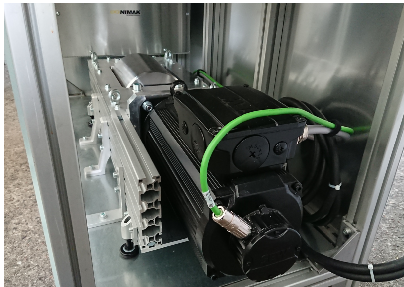
Abbildung 65: Foto des Schwungmassenspeichers inkl. elektrischer Maschine, Umrichter, Schwungmasse und Transformator-Gehäuse.
