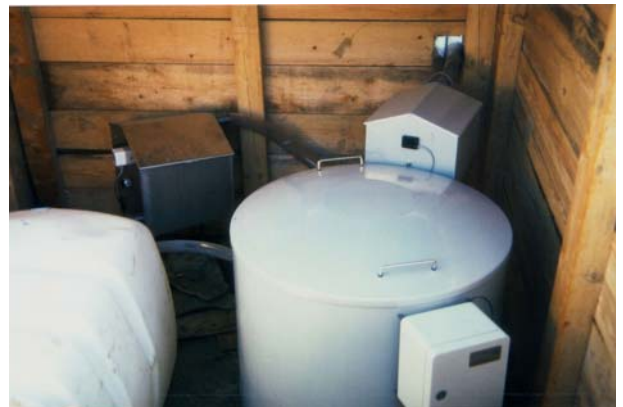
Abb. 10: Installiertes Messsystem mit Kippwaage, Bypass zum Auffangtank und Datalogger
