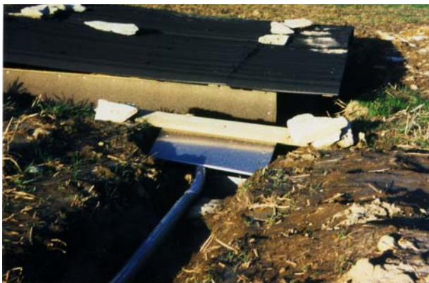
Abb. 9: Abfluss-Zulauf mit Verteilerkasten zum Messsystem in der Schutzhütte
