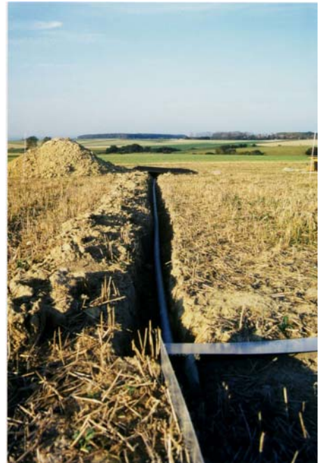
Abb. 8: Rohrsystem für die Ableitung von Oberflächenabfluss zum Messsystem
