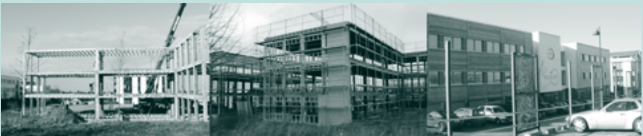
Das im Rahmen des Energy Globe ausgezeichnete Demonstrationsprojekt für gesamtökologisches Bauen – Eine Idee und gesamtenergetische Konzeption der Arbeitsgruppe
